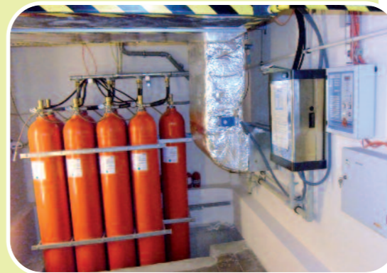
Zaplecze techniczne – pawilon 7
